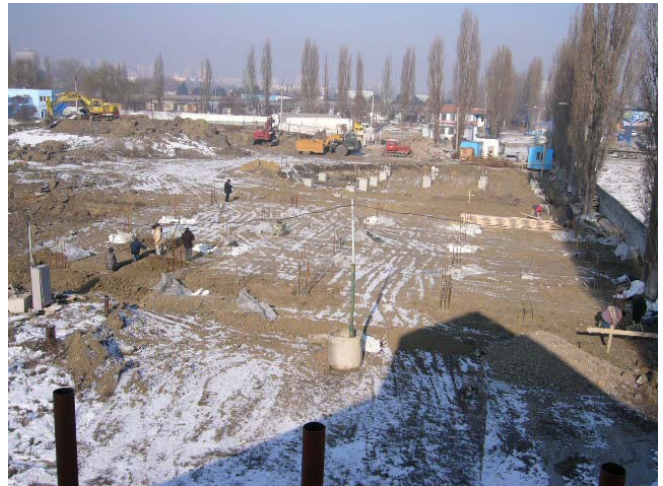
2006年2月7日現在。基礎部分のコンクリート打設を終わって、埋め戻しを完了したところ。
