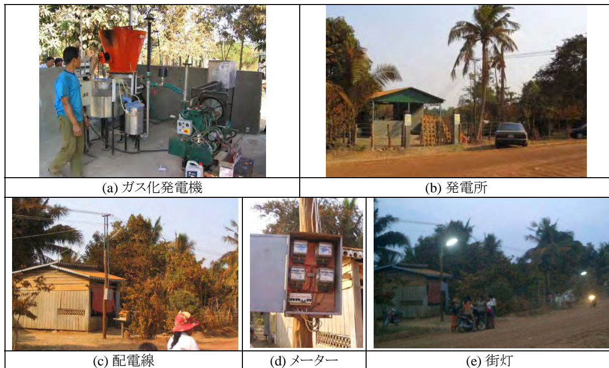
Figure AP-C.4.5 アンロンタメイ村バイオマス電気組合事業
