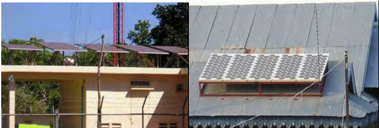
(a) 中型 PV システム (b) 小型 PV システム 図 5.3.4 無線通信基地局に設置されている PV システム
