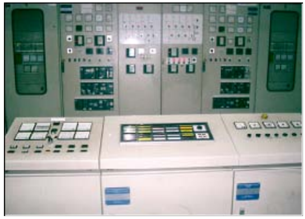
キングトム発電所監視制御盤
