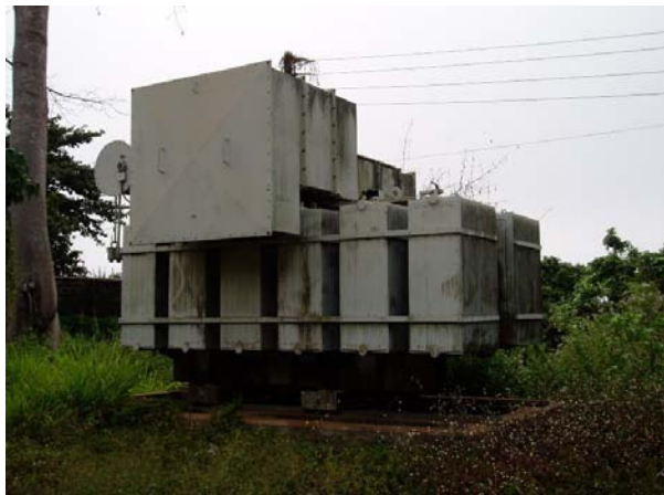
ウイルバフォース1次変電所にある 33/11 kV変圧器
