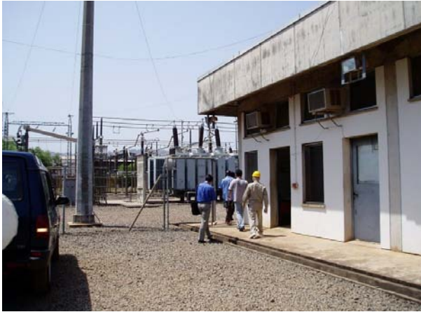
キングトム161/33 kV変電所
