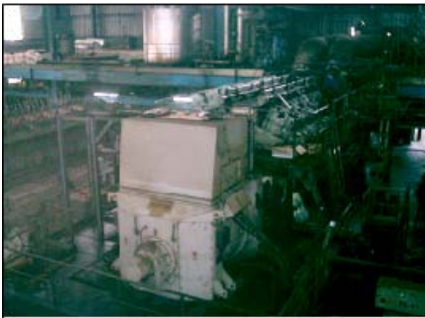
Mirrlees製発電機(6MW)
