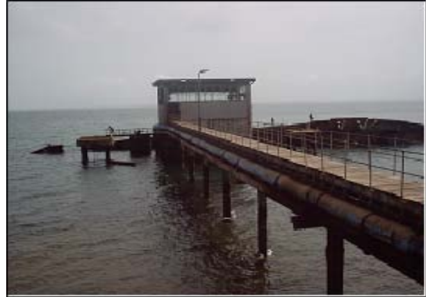
海水取水ポンプステーション
