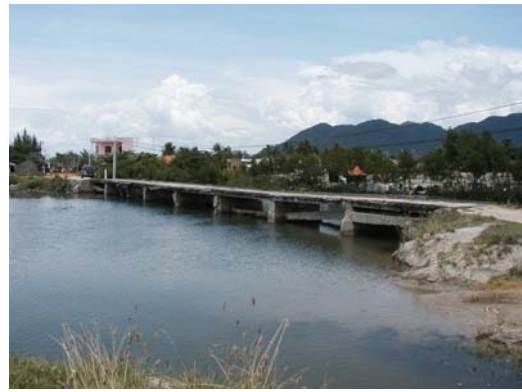
現橋 : 古いコンクリート橋が残存
