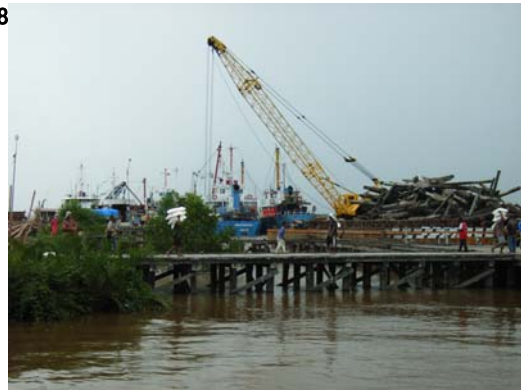
流通等：アグロビジネスサブセンター建設予定地の Sambas 県 Semparuk 郡の Sintete 港の現状。大型船就航に向けて浚渫が行われる予定。
