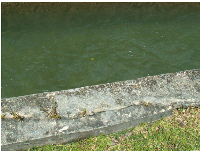
(5) 水路本体のひび割れ
