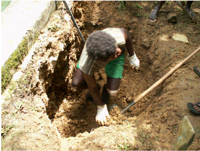
(7) クラックの埋め戻し工事。その上に写真(10)のプラスチックシートを被せ雨水の浸入を防ぐ。
