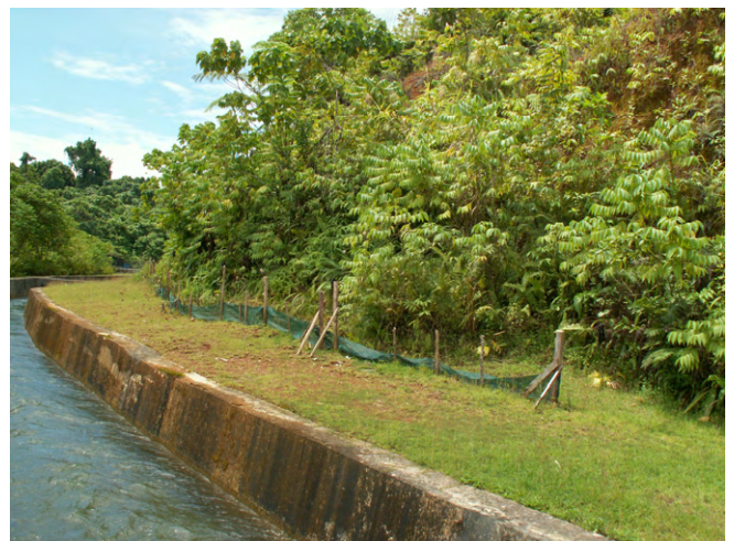
(6) 土砂流入防止ネット (管理されていない。)
