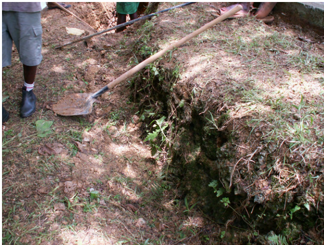
(9) 地滑りによって生じた段差
