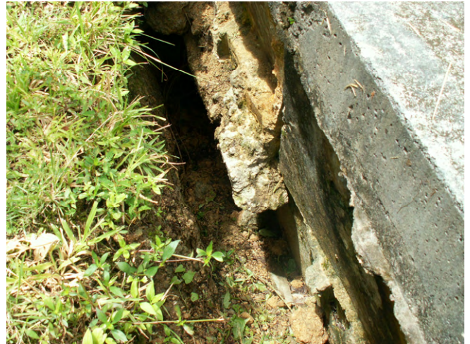
(4) クラックの内部 (かなり深くまでクラックが進行している。)
