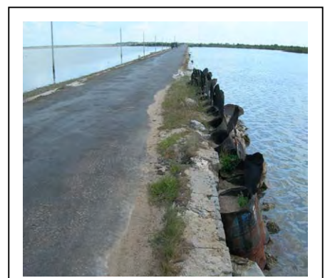
崩壊した土留め擁壁の代わりにドラム缶を用いている
