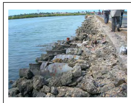
損傷したパイプカルバート
