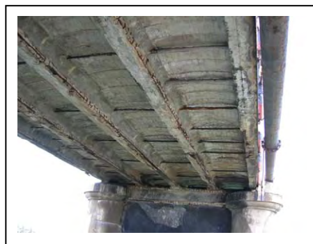
鉄筋が露出した上部工
