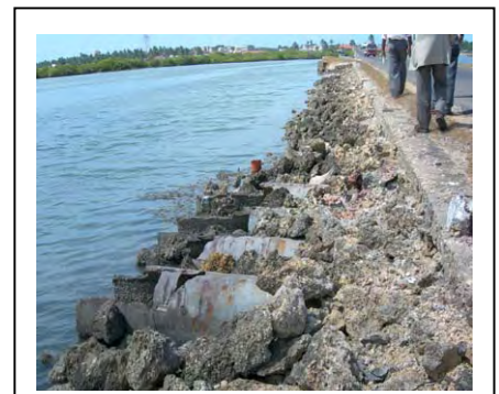
老朽化のため著しい損傷が見られる
