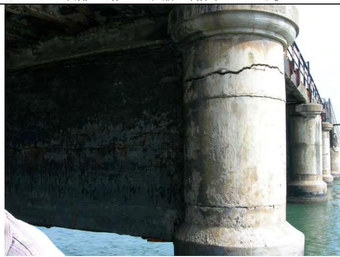
爆破の衝撃によって生じたと思われる橋脚の亀裂。
