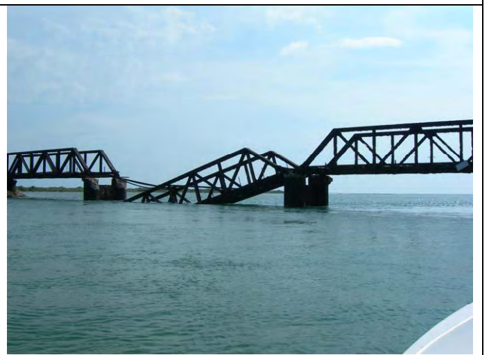
爆破され落橋した鉄道橋。この鉄道橋も本島とマナー橋を結んでいたが、現在は廃線となっている。
