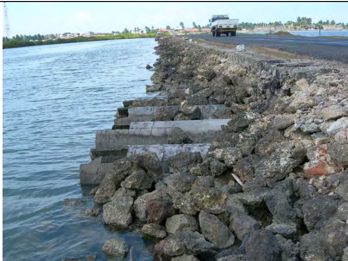
改築されたパイプ式カルバート。しかし老朽化が著しく、押しつぶされたパイプもある。
