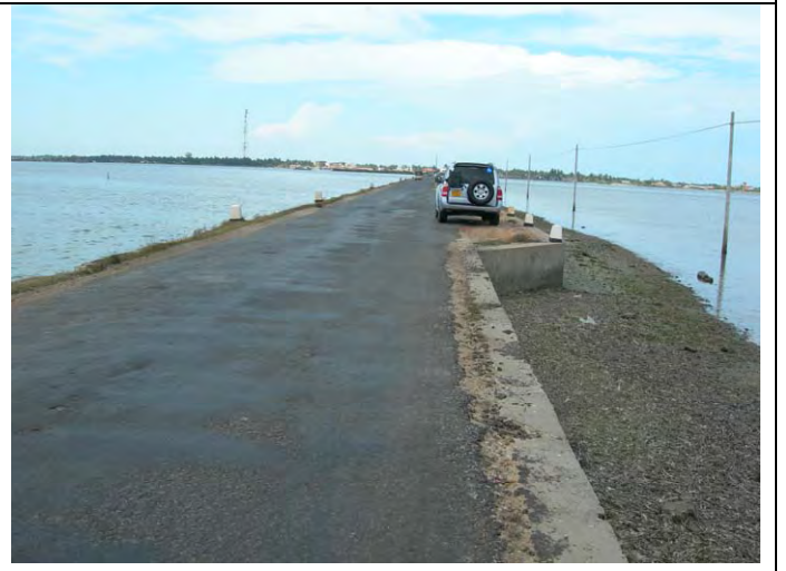
コースウェイ上における車両行き違いが困難なため、数箇所の停車帯が設けてある。
