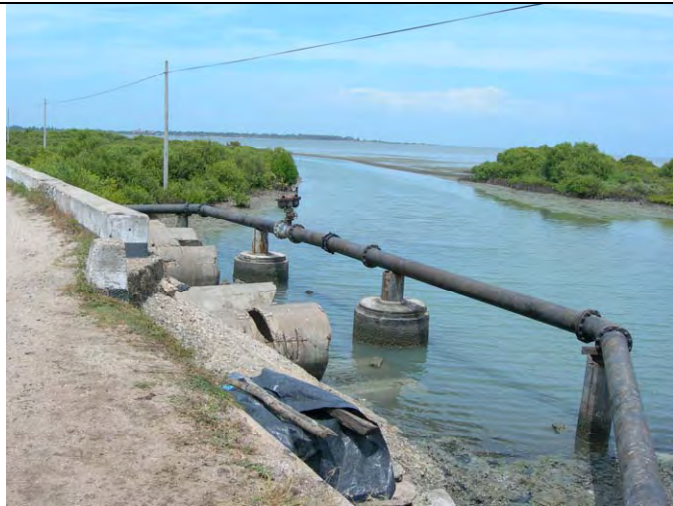
マナー島へ毎時 150m 3 の水量が供給されている径 250mm の水道管。
