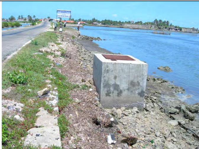
コンクリート柵に設けられた水道管用空気弁。写真右側には電話線のケーブルが見られる。
