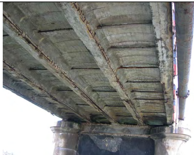
下から見た単純 RC 桁橋。著しい老朽化のためコンクリートは剥離し錆びた鉄筋が露出している。
