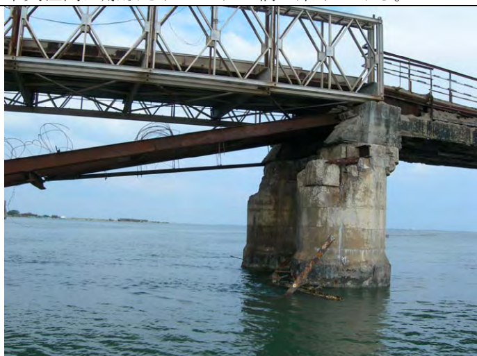
爆破された中央径間部の本島側橋脚と落橋した鋼製下路トラス。
