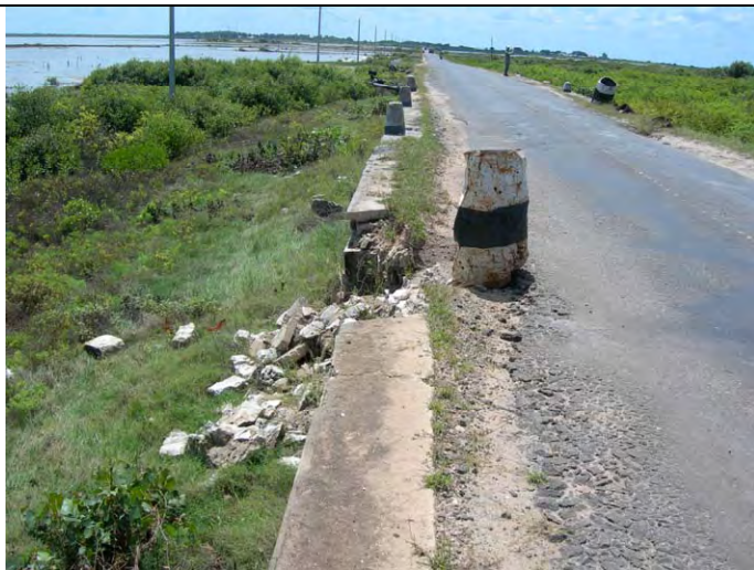
コースウェイの土留め擁壁が崩壊したため、土砂を詰めたドラム缶を設置し、車両の転落事故を防いでいる。
