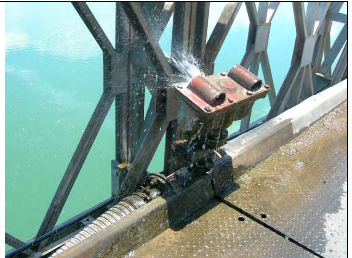
マナー橋上に添架されている水道管。パッキンが不良のため漏水している。
