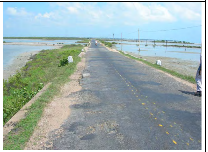
バス、トラックなどの大型車の走行により舗装面は凹凸が著しく、不快な走行を強いられている。
