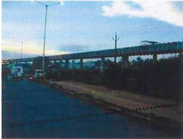
Margao 市 計画下水管路流末付近 右手は建設中のエアバス（下部に既存鉄道）
