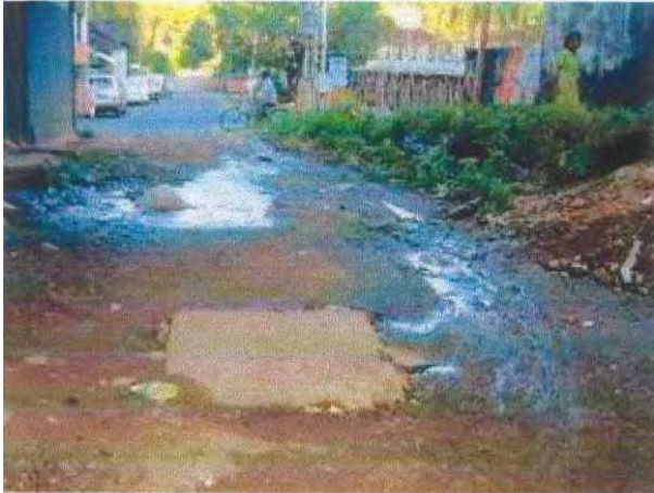
Margao 市 浄化槽からの汚水流出
