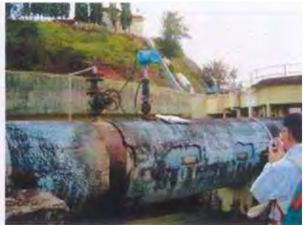
既設 160MLD Salaulim 給水システム 浄水場内配管
