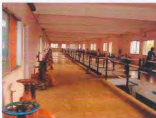
既設 160MLD Salaulim 給水システム ろ過ポンプ
