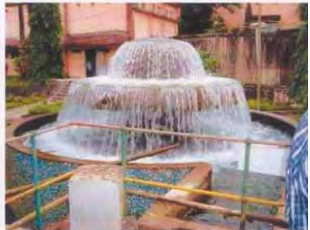
Opa 浄水場 エアレーター
