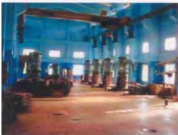
既設 160MLD Salaulim 給水システム 取水ポンプ
