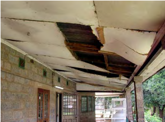
事務棟天井漏水跡。屋根材老朽化による雨漏り。
