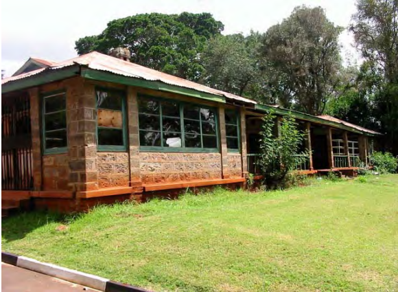
事務棟外観。老朽化が著しく解体予定。
