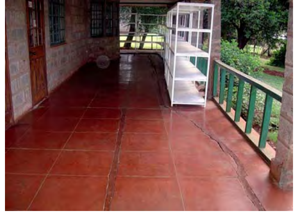
事務棟床クラック。基礎沈下が原因と思われる。
