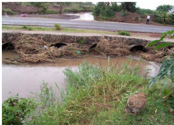
アワチ - カノー川渡河地点カルバート 閉塞状況
