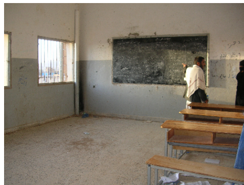
窓ガラスがなく、かなり寒い
