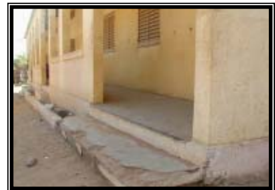
世銀建設による教室棟：クリコロ州 比較的新しい教室棟であるが、基礎部分や床・壁の不 具合が多く、施工精度が保たれていない。
