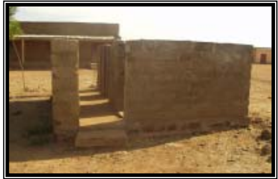
日干し煉瓦造の既存便所： 日干し煉瓦の壁だけの便所。男女、教員の区別が無く、 扉・屋根も無いため女子児童は使用できない。
