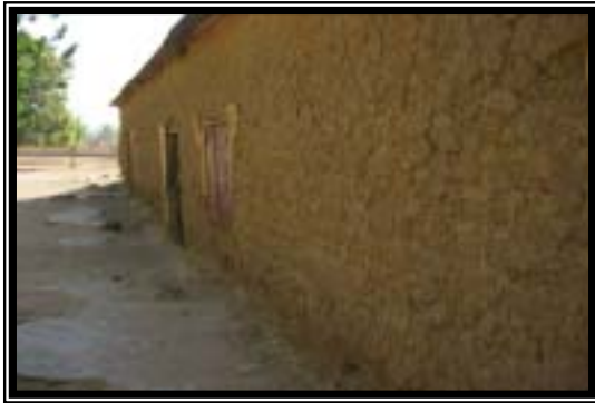
日干し煉瓦造の既存教室： 風雨によって教室の外壁が崩れかけている。他に施設 が無いため、危険な建物を使わざるを得ない。
