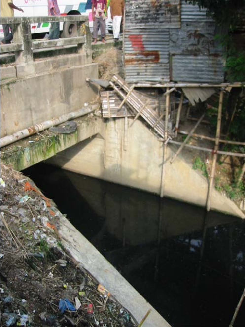
1. 前回無償で整備されたボックスカルバートおよびカラヤンプル排水路(ミルプール道路南西部から撮影)
