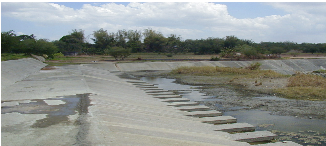
頭首工への堆砂（アガナン・サンタバーバラ国営灌漑システム）
