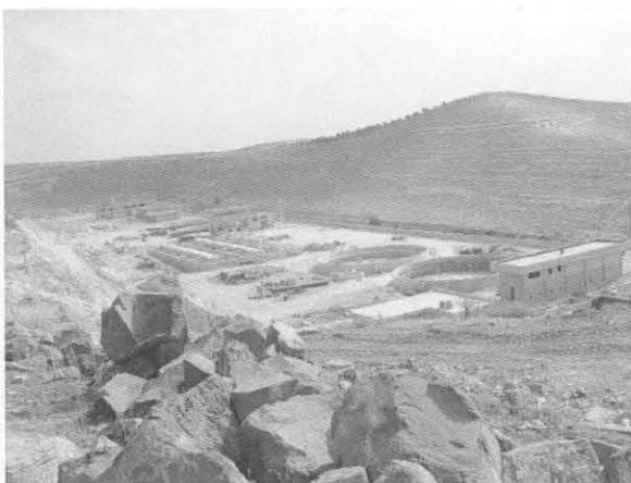
ダラア下水処理場建設中（土木工事のみ） 機械設備設置の時期は未定
