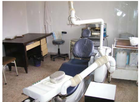
歯科ユニット 生活習慣病同様、虫歯が人口の大部分を蝕んで いるため、歯科が充実している。ハンドピース、 圧縮空気、給水等の設備があり、稼働する。
