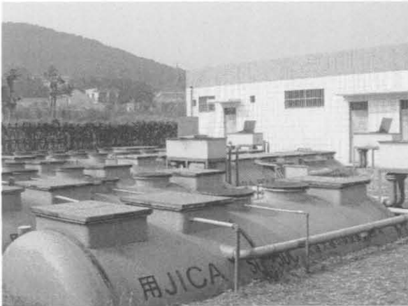
高度処理浄化槽
