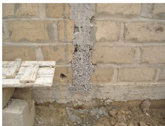
コンクリート打設方法および型枠の精度が悪いため足元にジャンカができる
