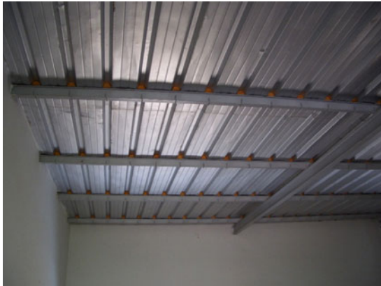
取り付けフック部分全箇所にも木片がある
