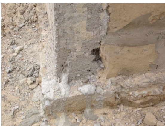
ブロックとの隙間にコンクリート・スラリーが回っていない
