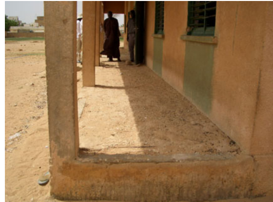
犬走りの床が破損してほとんど無い
