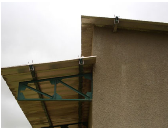
庇と壁の雨仕舞いが十分考慮されていないため、壁左官工事が後工事となる
