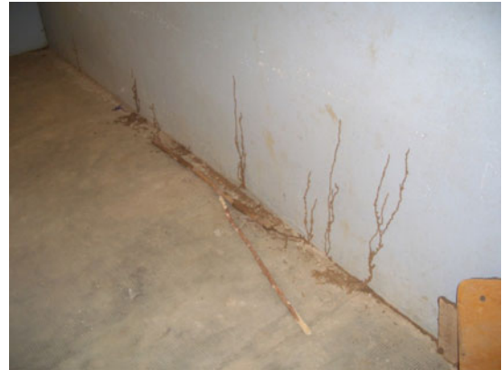
土間の目地部分からシロアリが室内に侵入し、木片部に巣を作っている
