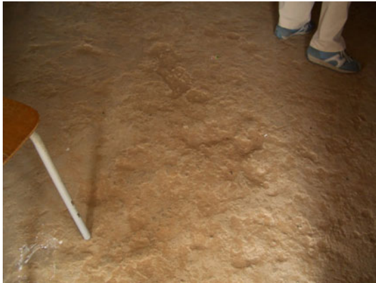
床モルタルが破損
