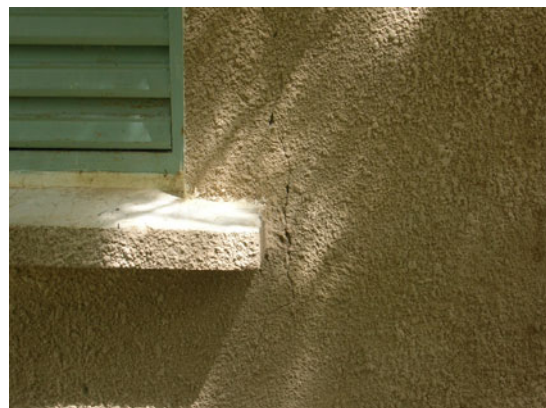
同左 壁面クラック
