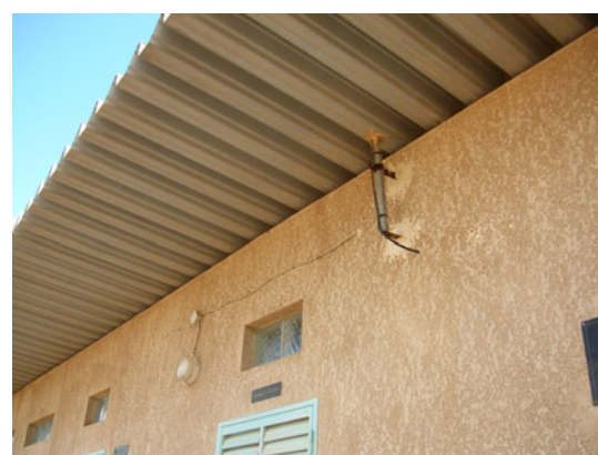
無償資金協力の教室に小型ソーラーパネルを利用した照明器具が取り付けられていた
