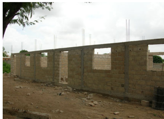
建設中の BCI 教室（鉄筋が露出している）
