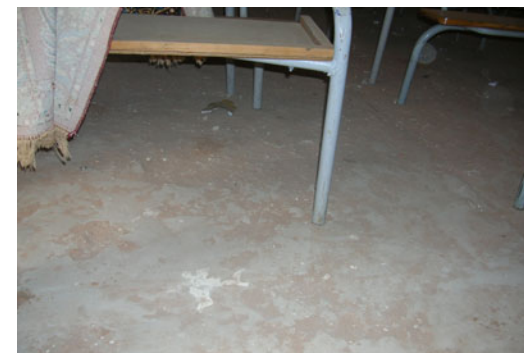
椅子によって剥離した床面
