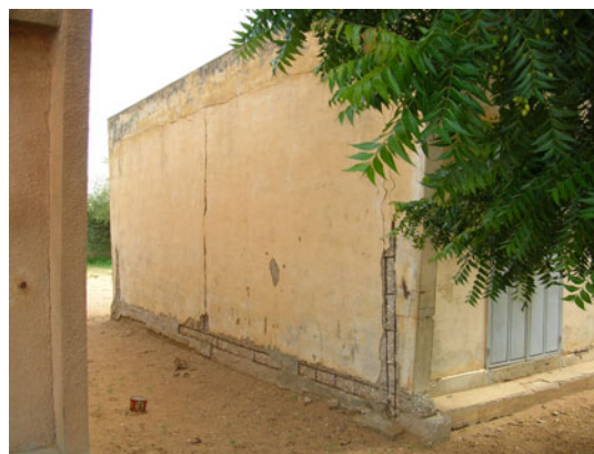
むき出しの鉄筋と大きなクラックの外壁
