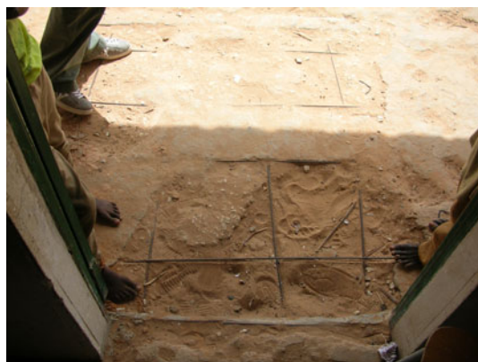
完全に剥離した床コンクリート
