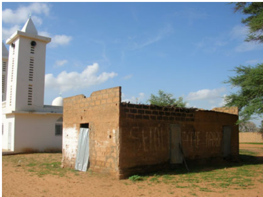
老朽化した 2 教室棟（白い建物はモスク）
