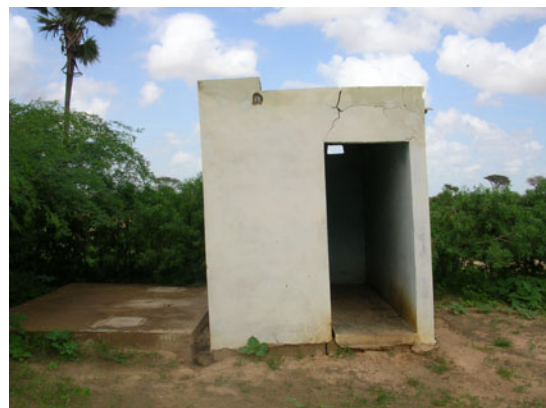
沈下を起し危険なトイレ
