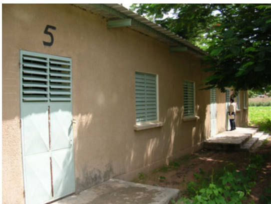
世銀 (1998年) 玄関床の剥離
