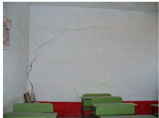
写真 16 国立小学校教室内のひび割れ
