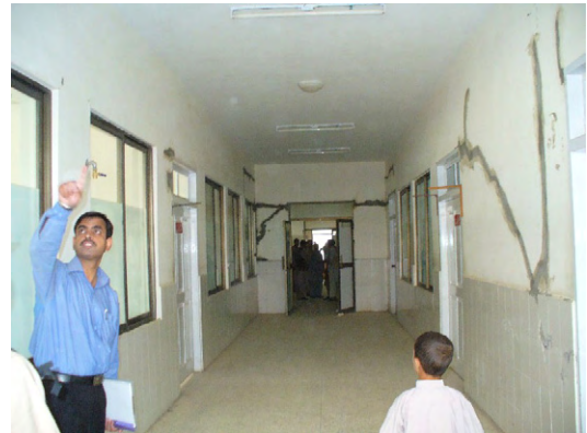
写真 14 病院新館 1 階廊下のひび割れ
