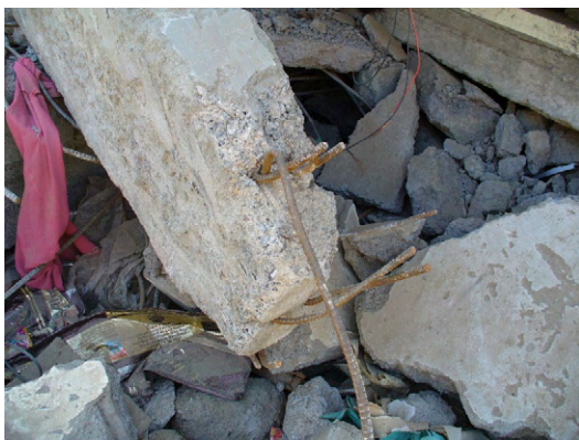
写真 5 倒壊した鉄筋コンクリート造ホテルの詳細(写真 4 の詳細)
