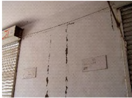
写真 7-2 同左の内部 構造材（柱、梁）と間仕切り壁との間にクラックが入っている
