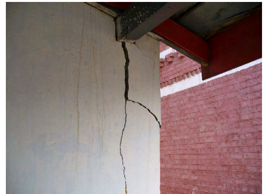
写真 24 レンガ造壁隅角部のひび割れ
