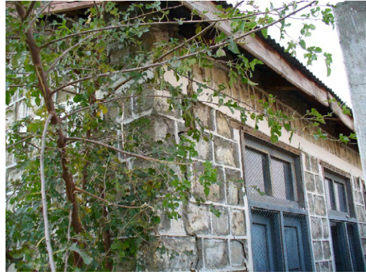
写真 18 州立小学校壁隅角部のひび割れ (外観)
