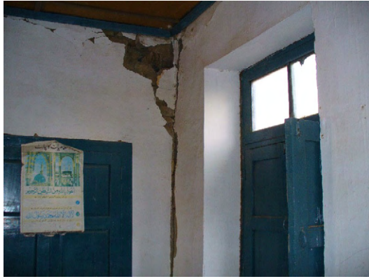
写真 17 州立小学校壁隅角部のひび割れ (教室内)
