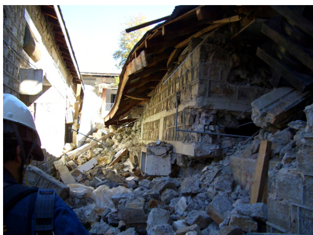
病院倒壊の様子
