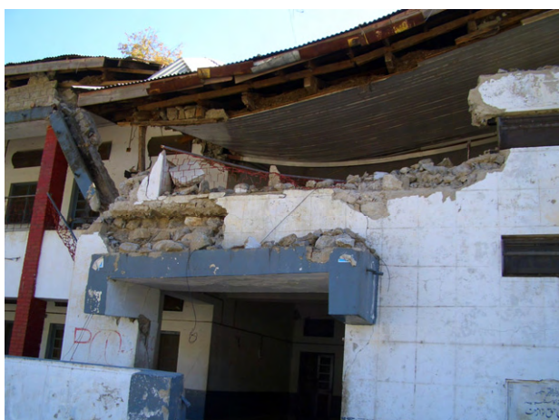
病院倒壊の様子
