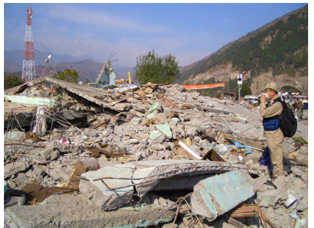
バラコット小学校の倒壊現場
