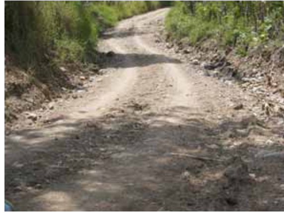
村落間の連絡道路の状況 (側溝がなく道路の崩壊が起こりやすい)
