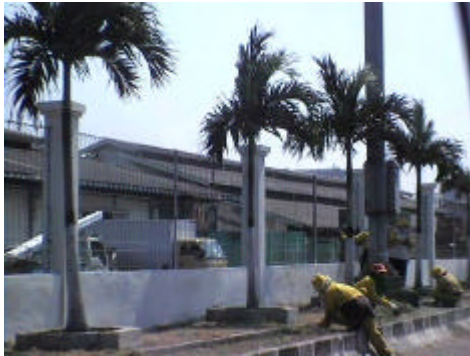
写真-9 Jamrud 埠頭内フェンス →施工中、有刺鉄線の配置未了
