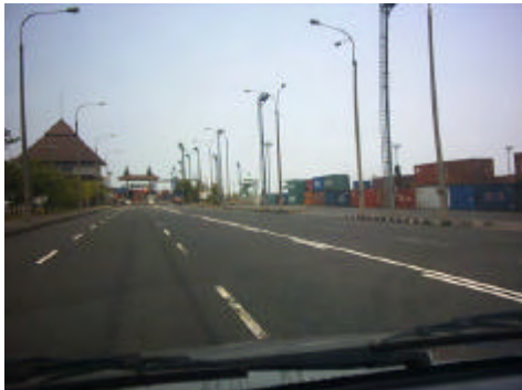
写真-23 Tanjung Emas 港 TPKS 内の照明設備
