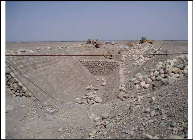
8. 为了除砂而建立的沈砂池 (托克逊县依拉湖乡红枣滴灌项目)
