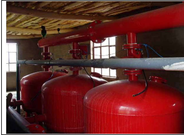
7. 为了对水源水进行处理的过滤装置 (澳大利亚製、吐鲁番市红柳河园艺场)
