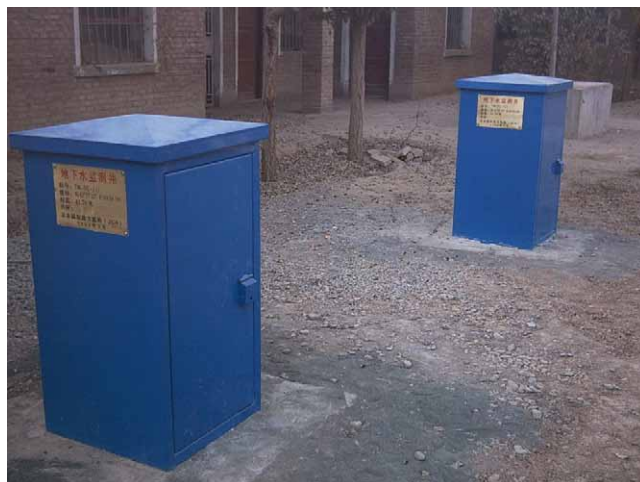
照片 7.1.4 JICA 观测井的保护箱（TW-SC 试掘点）
