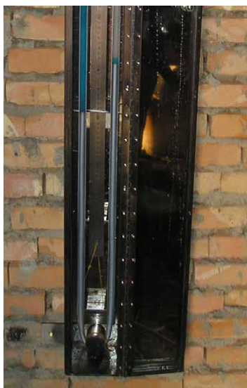
照片 4.5.1 在 TW-SW-1 观测井设制的 U 字型水银管式压力计
