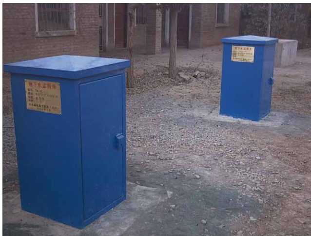
图 7.2 JICA 观测井的保护箱 (TW-SC 观测井)
