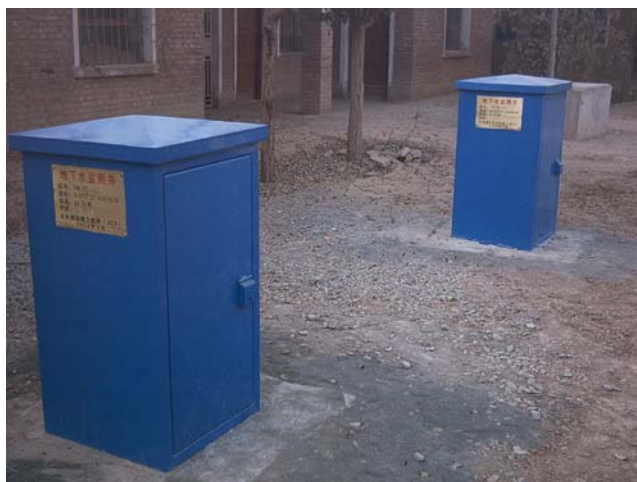
写真 7.1.4 JICA 観測井の保護箱(TW-SC 地点)
