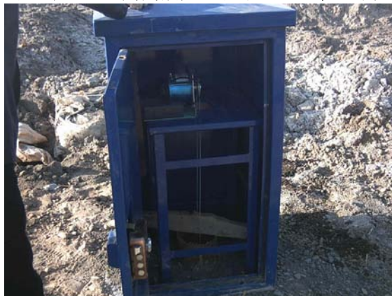
写真 7.1.1 JICA 観測井に設置した自記水位計
