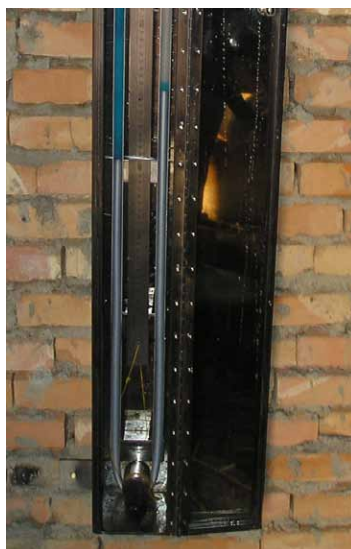
写真 4.5.1 TW-SW-1 観測井に設置したU字型水銀式圧力計
