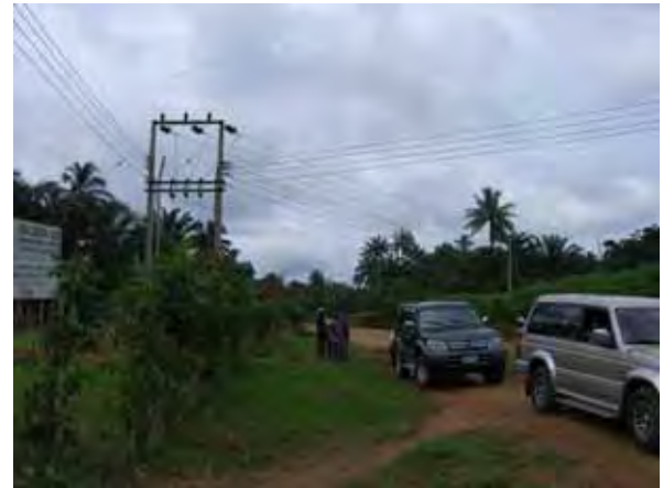
既設33kV配電線との接続点
