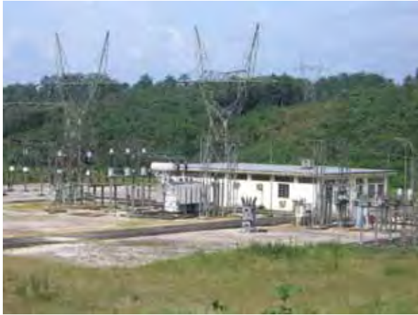
イツ変電所(132/33kV, 1×15MVA)
