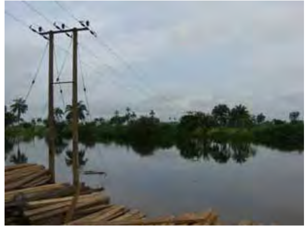
既設 33kV 配電線の様子
