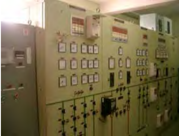
アバカリキ変電所(132/33kV、1×30MVA + 3×15MVA)
