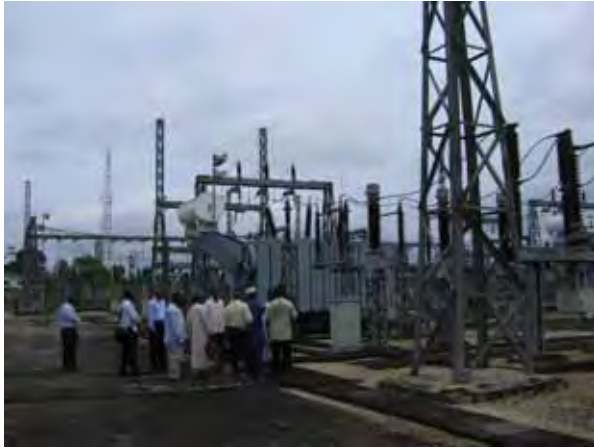
ウヨ変電所(132/33kV、2×40MVA)
