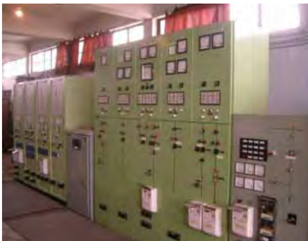
変電所(132/33kV)内の操作盤
