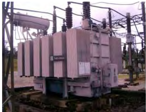
変電所(132/33kV)内の変圧器(15MVA)
