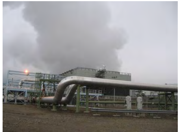
発電所冷却塔(凝縮水の 75%は大気中に放出)
