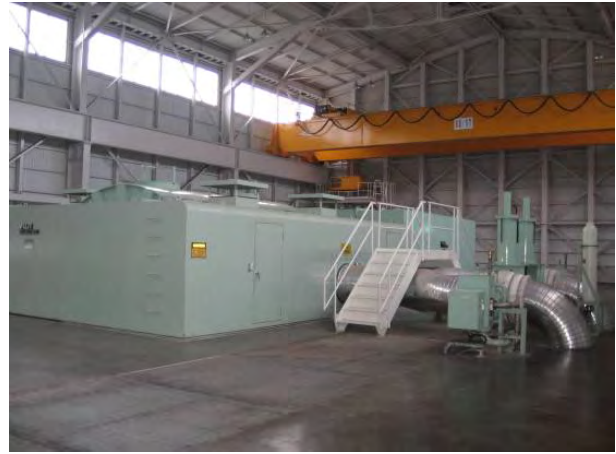
世界最大の 110MW 地熱蒸気タービン発電機
