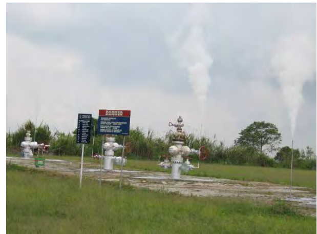
4号機（増設）用の生産井
