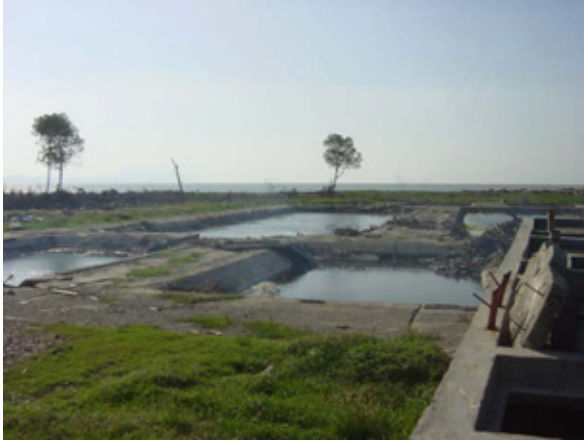
被災後のし尿処理場
