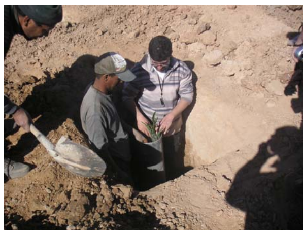
ダブルサック工法による植林の状況, Bouya, Dec 4, 2004 PVC パイプを用いて、先に掘った植林用の穴の中に内サックおよび外サックを設置した。
