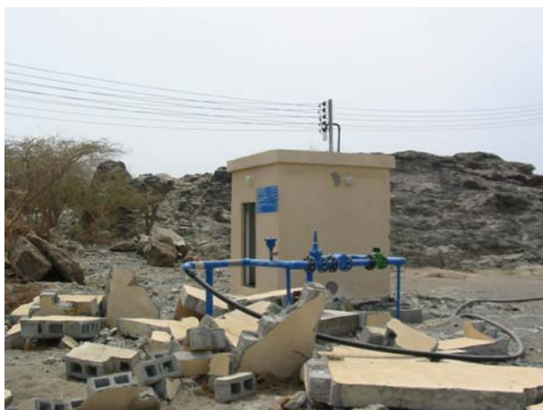
水資源局により建設されたポンプ施設
