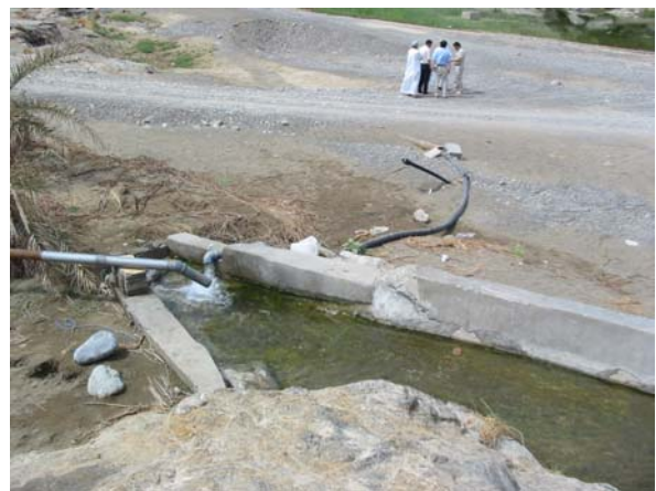
ポンプからファラージへ導水されている。
