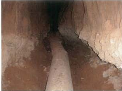
PVCパイプの敷設状況（パイプ敷設前に底部の整形工事を行っている）
