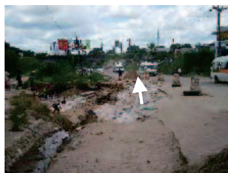
排水施設の不備による洗掘個所
