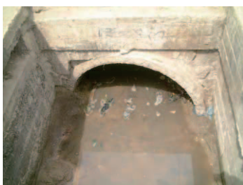
柵、排水管の堆砂状況
