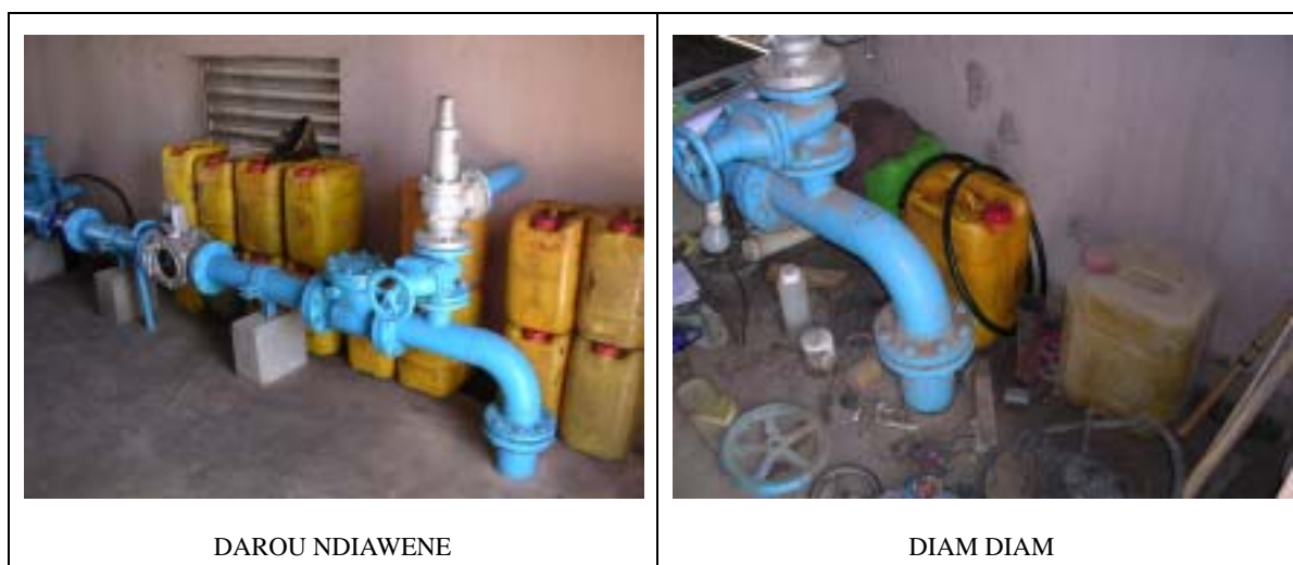
Photo Etat de propreté de la cabine de pompage
