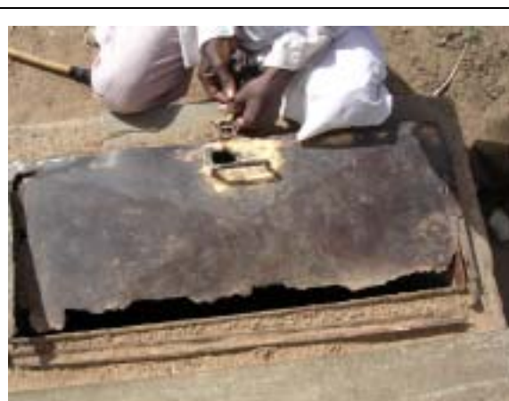
Couvercle de chambre de vannes cassée (DAROU NDIMBELANE)
