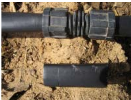
Tuyau grignoté par l'écureuil( en bas ) Point à réparer avec joint ( en haut )
