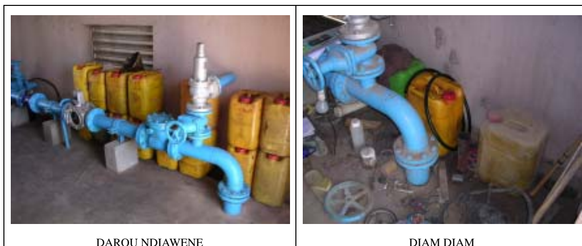
写真 7.5.2 機械室内の清掃 / 整頓状況の違い (いずれも 1995 年建設)
