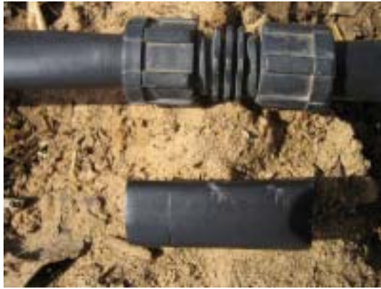
地リスが齧り破損したホース(下)と ジョイントによる補修箇所(上)
