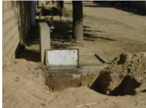
公共水栓に水量計を設置している
