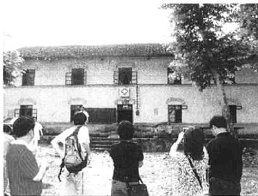
11. 上埴郷の衛生院。老朽化していて、崩壊の危険性がある建物（「危房」）と認定されている。
