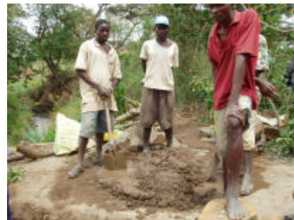
LBT によるアーチ橋の建設 3 コンクリート練り混ぜ作業
