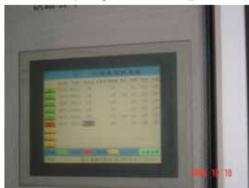
図表 III-145 壁面の冷蔵装置モニター
