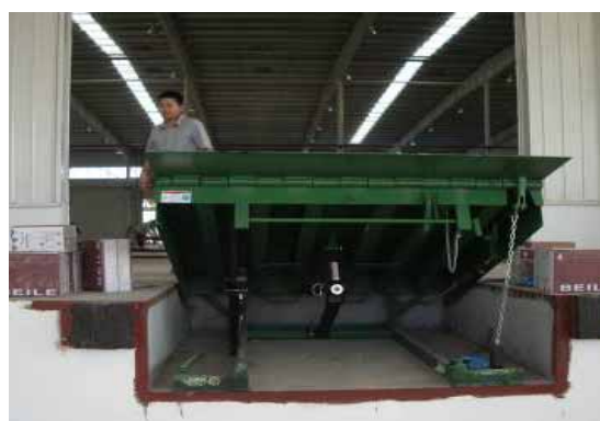
図表 - 114 ドックレベラー
