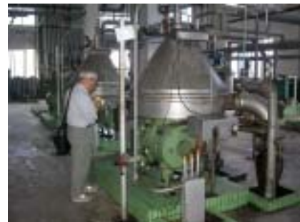
精製工程 19. 遠心分離機
