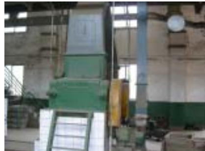
9. 粗砕ロール 圧搾工程
