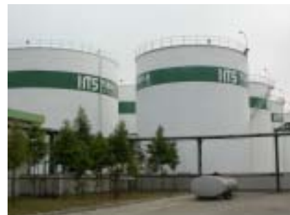
20. 原油 貯蔵タンク
