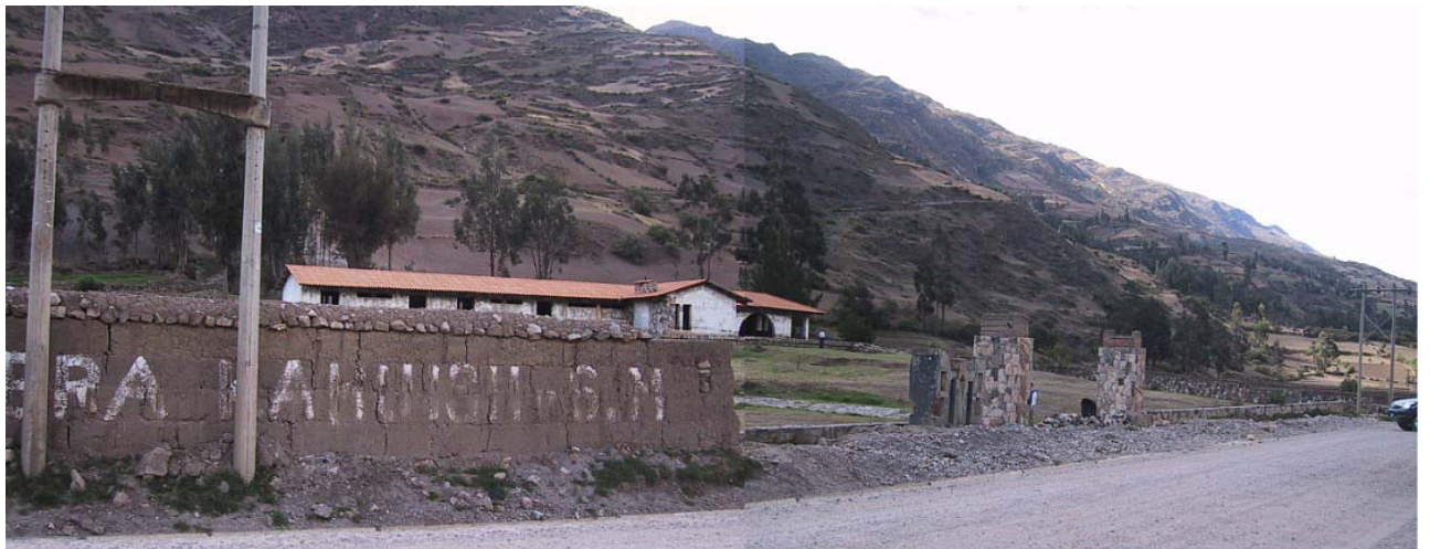
アプローチ方向から敷地を見る。前面道路に架空給電線が通っている。道路は舗装工事中で路盤と側溝の工事を終えている。左手前は隣接農地の区画塀。
