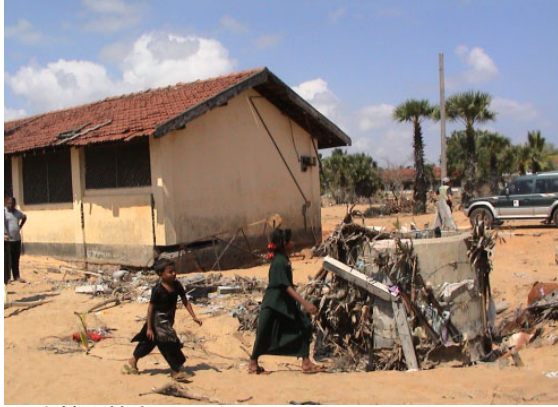
浸水被災校舎(2005年2月)
